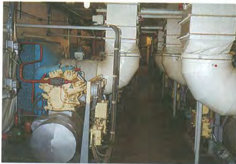
Обладнання холо- дильного центру ракетного комплексу
