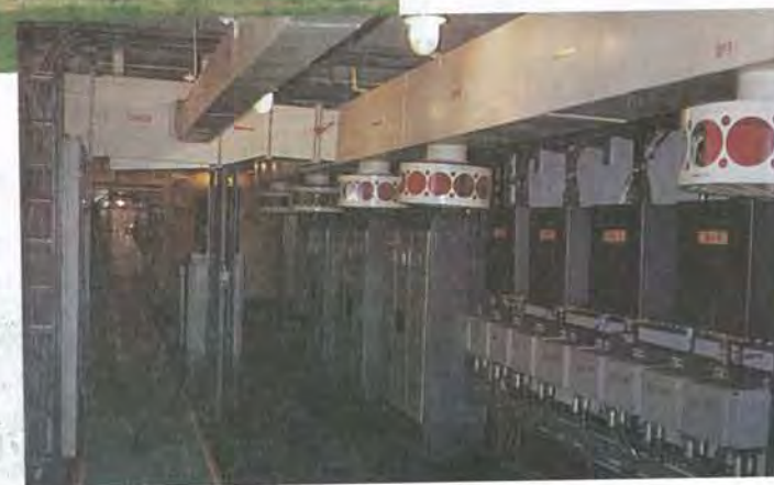
Обладнання холодильного центру ракетного комплексу
