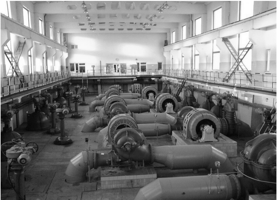
Pumpstation Dniprovs'ka der Kiewer Wasserbetriebe
